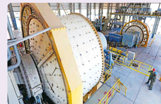
中色非矿东南矿体选矿车间采用当前世界上最先进选矿工艺设备
